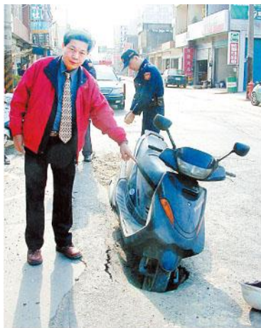
▲圖 8-3-1 若因路面施工不良，導致民眾安全與財產受到損害，屬於公共設施管理有欠缺，得請求國家賠償。
